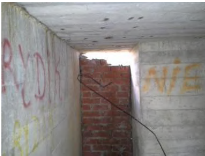
volledig dicht te metsen toegang
